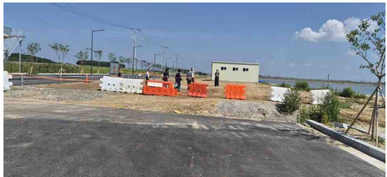
▲ 배수펌프실(가설건축물형) - 해안측 도로가 끝난 흙바닥 위에 설치(현장점검)
