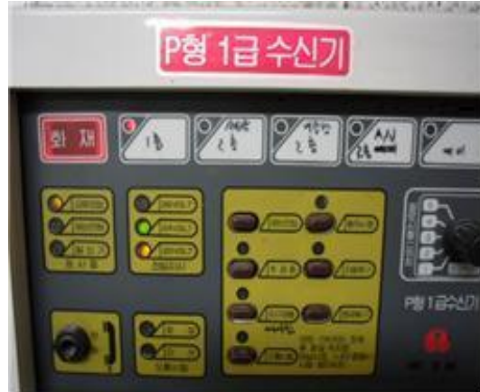
▲ 화재 오동작시 복구하지 않고 방치한 경우
