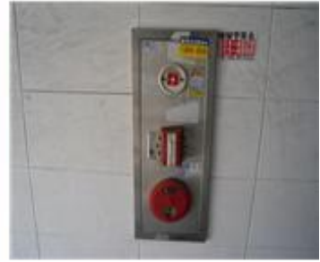
▲ 위치표시등의 파손을 방치한 경우
