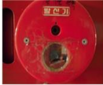
▲ 발신기의 파손을 방치한 경우
