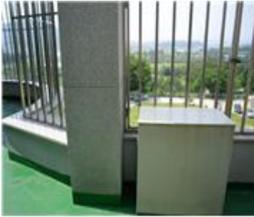
▲ 구조대 설치 장소에 창살과 시건 장치로 사용이 제한되는 경우
