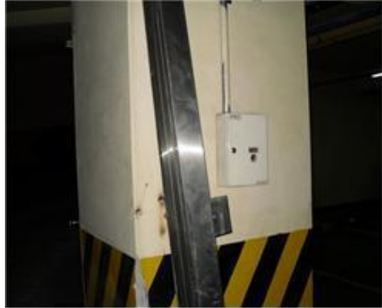
▲ 방화셔터 레일이 파손된 상태로 방치한 경우
